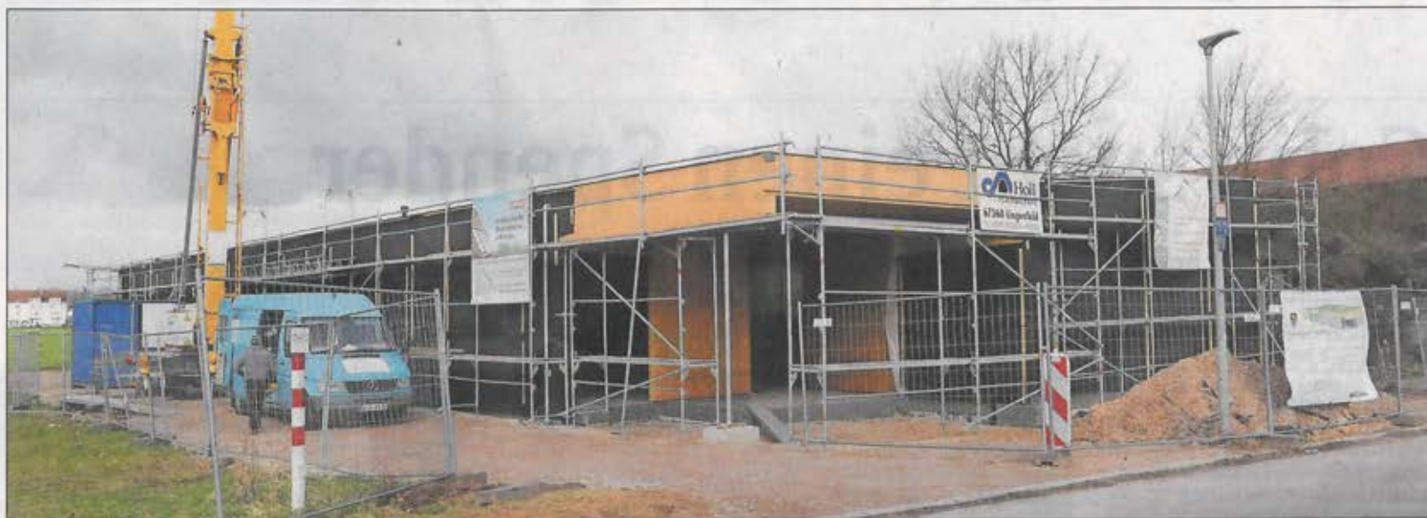
Im Zeitplan – trotz des schlechten Wetters in den vergangenen Wochen: die Baustelle der Kita „Am Hasenspiel“
